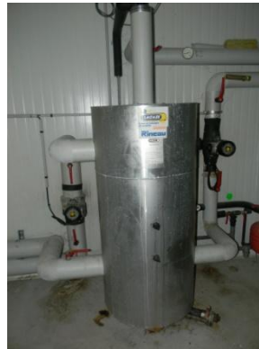
Figure 13: Le dispositif de production d'eau glacée
