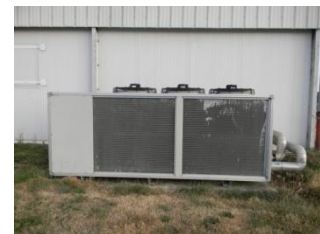
Figure 17: Groupe froid Bâtiment 470
