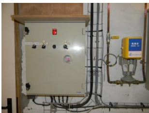
Figure 15: Armoire de régulation- Bâtiment 449
