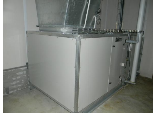
Figure 6: La centrale de traitement de l'air du bâtiment 446
