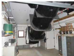
Figure 16: Gaine entrée d'air conditionné - Bâtiment 449
