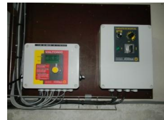
Figure 23: Autre armoire de régulation. Bâtiment 453
