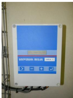
Figure 21: Armoire de régulation. Bâtiment 460
