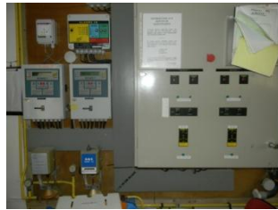
Figure 19: Armoire de régulation Bâtiment 435 (vue élargie)
