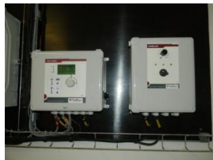
Figure 22: Armoire de régulation. Bâtiment 453
