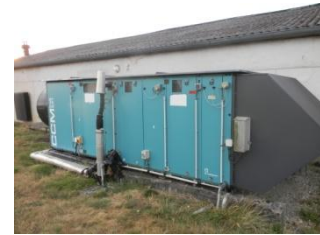
Figure 20: Centrale de traitement d'air. Bâtiment 449
