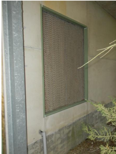
Figure 5: Un des trois pad cooling du bâtiment 446
