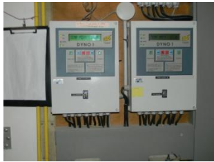
Figure 18: Armoire de régulation Bâtiment 435 (détail)
