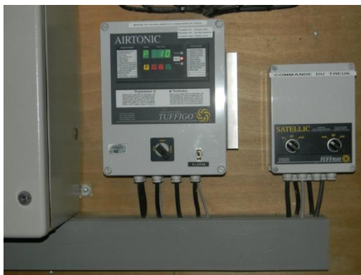
Figure 3: Armoire de régulation AIRTONIC (TUFFIGO) pour la ventilation/température (cellule 12)
