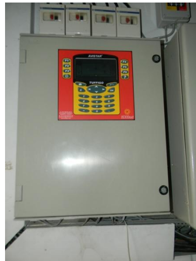
Figure 4: Armoire de régulation AVISTAR (TUFFIGO) pour la ventilation/température (cellule 11)
