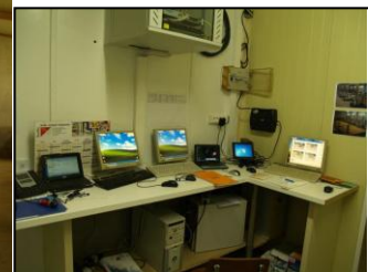
Figure 23: Le local de contrôle dans le bâtiment 36
